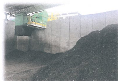
Stabilizacja tlenowa II° pofermentu pod zadaszoną wiatą
