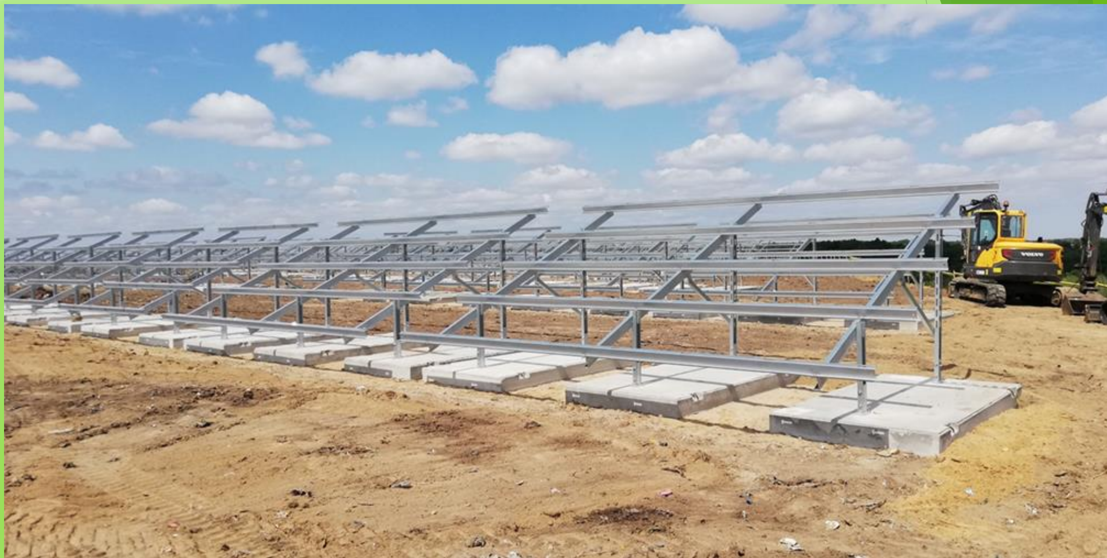
Konstrukcje wsporcze pod panele fotowoltaiczne
